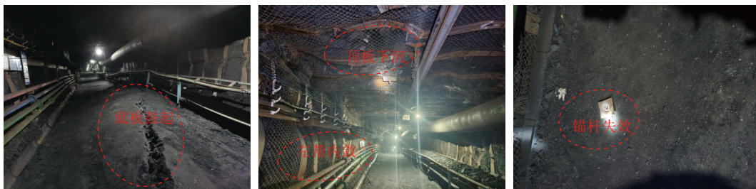
图 1 恒昇煤矿 9303 工作面回风巷形变破坏实拍
